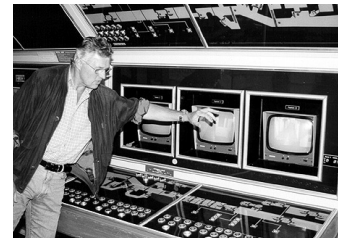
200 Meter unter den romantischen Weinbergen des Ahrtals: Kontrollzentrum des Bundesbunkers.
